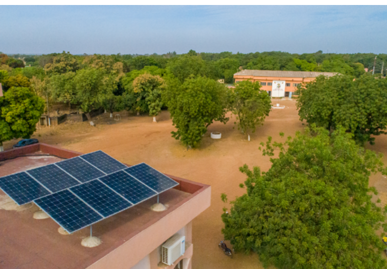
Panneaux solaires à la mairie de Kandî. Photo : DDC
