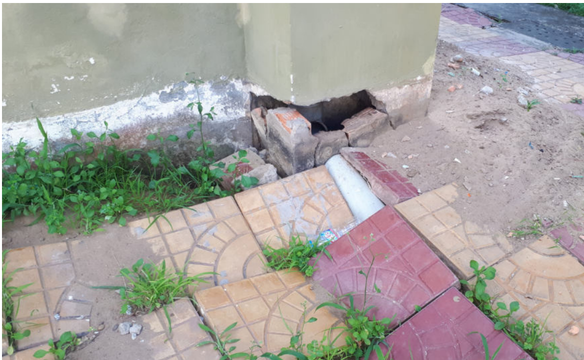
Hình 30: Tình trạng vỡ ống thoát nước mưa (Bệnh viện tại Cà Mau). Kết cấu của các toà nhà có thể bị hỏng do tình trạng sụt lún đất.
