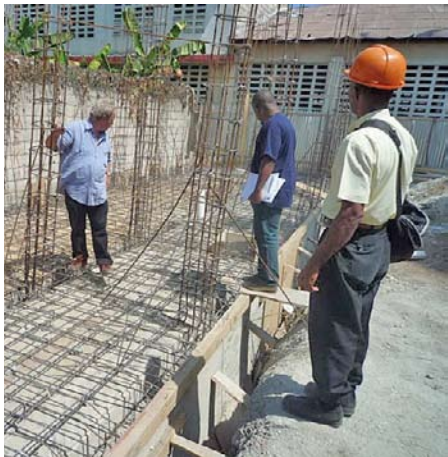
Expertos del Ministerio de Educación verifican con regularidad las obras en cuanto a la observancia de las normas edilicias
