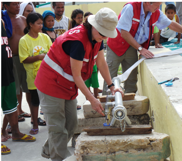
Mise en place d'un système de distribution d'eau potable par la l'Aide humanitaire. Source : DFAE
