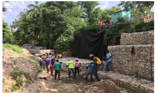
Travaux de construction de protection des berges en gabions dans la rivière des Orangers à Jacmel
