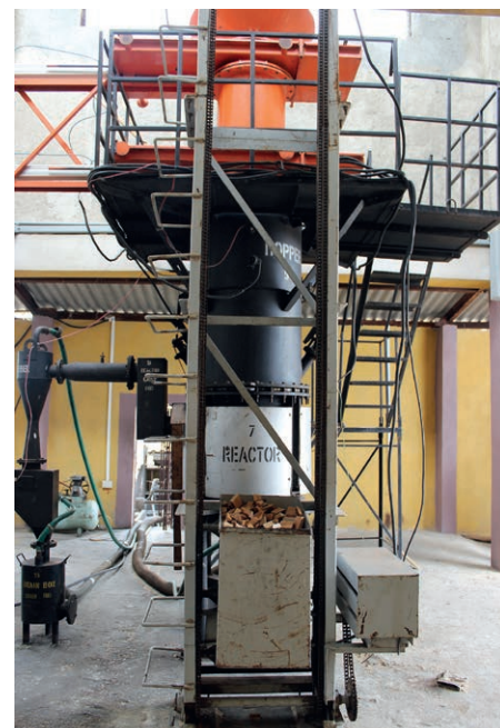
Planta de gasificación para generar energía a partir de biomasa
